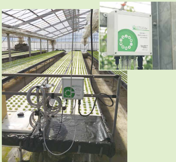
環境センサーデバイスをビニールハウスに設置
